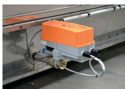
Vanne motorisée de vidange
