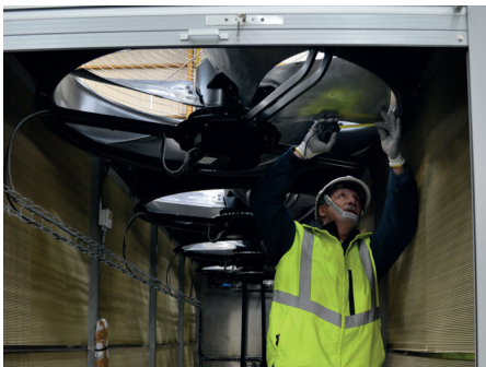
Contrôle des ventilateurs
